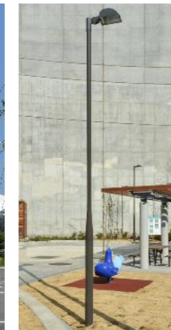
歩道照明(H=約5.0m)
