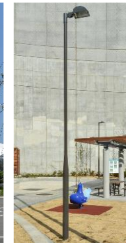
歩道照明(H=約5.0m)
