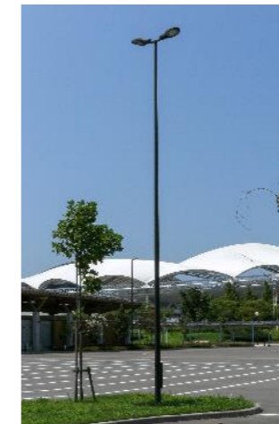
車道照明(H=約8.0m)
