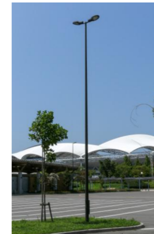
車道照明(H=約8.0m)
