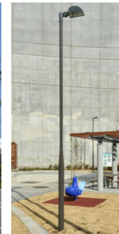
歩道照明(H=約5.0m)
