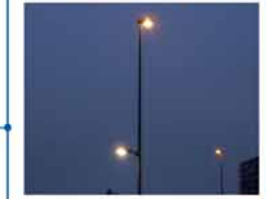
横断歩道付近を照らす歩行者兼自動車用 街路灯
