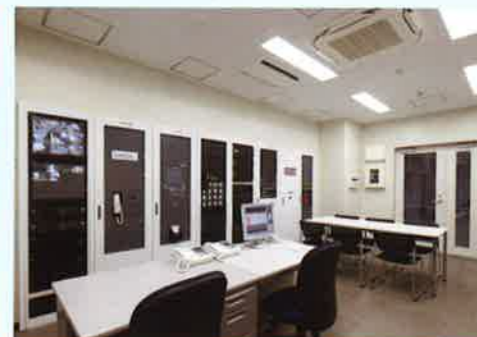
防災センター
