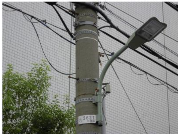
LED 街路灯設置状況
