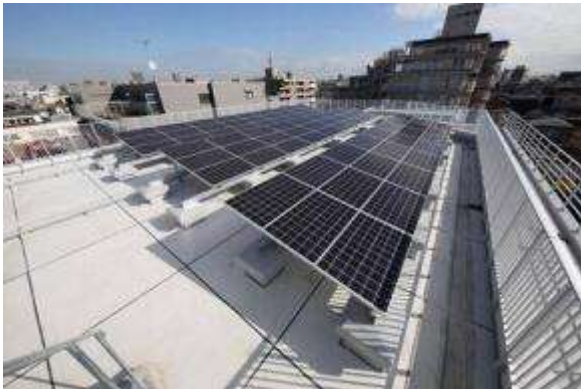
東六郷小学校 太陽光発電設備 20kW
