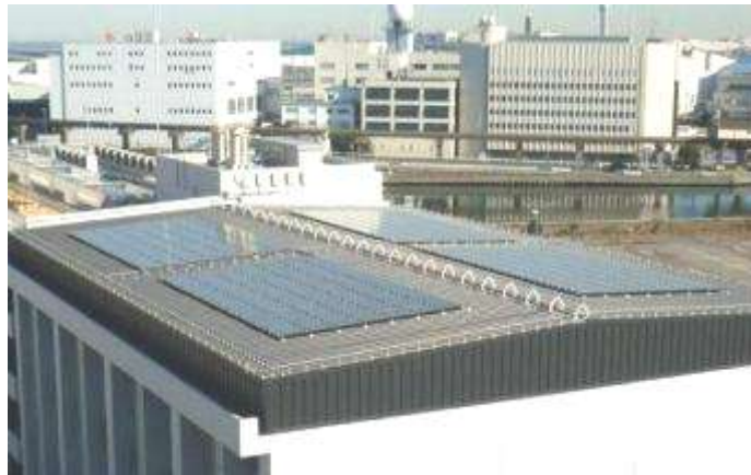
区立羽田中学校の体育館屋根に設置している太陽光発電*システム（50kW）
