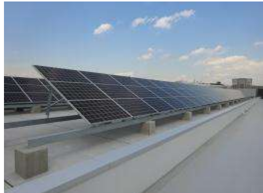
志茂田中学校 太陽光発電設備 50kW
