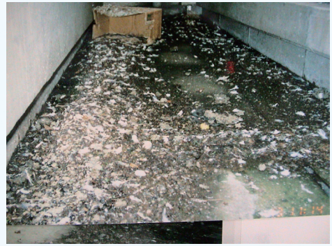
▲ハトのフンによる通路の汚れ 出典：東京都環境局
