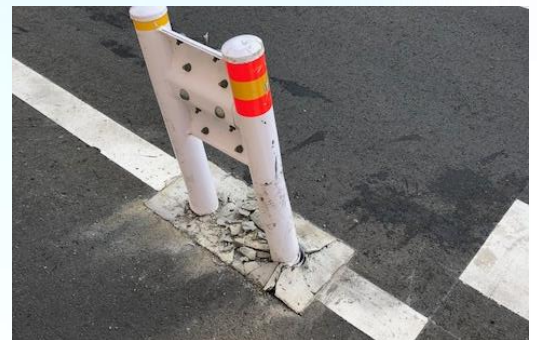
ガードレールの破損
