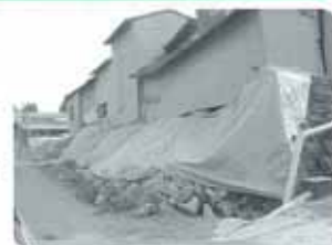
基礎が崩れて使用不能になった町工場
