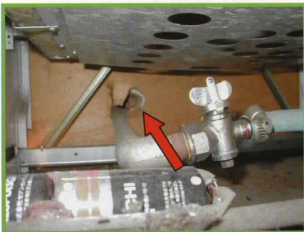
コンベック点検口内部より配管まわりに隙間が
