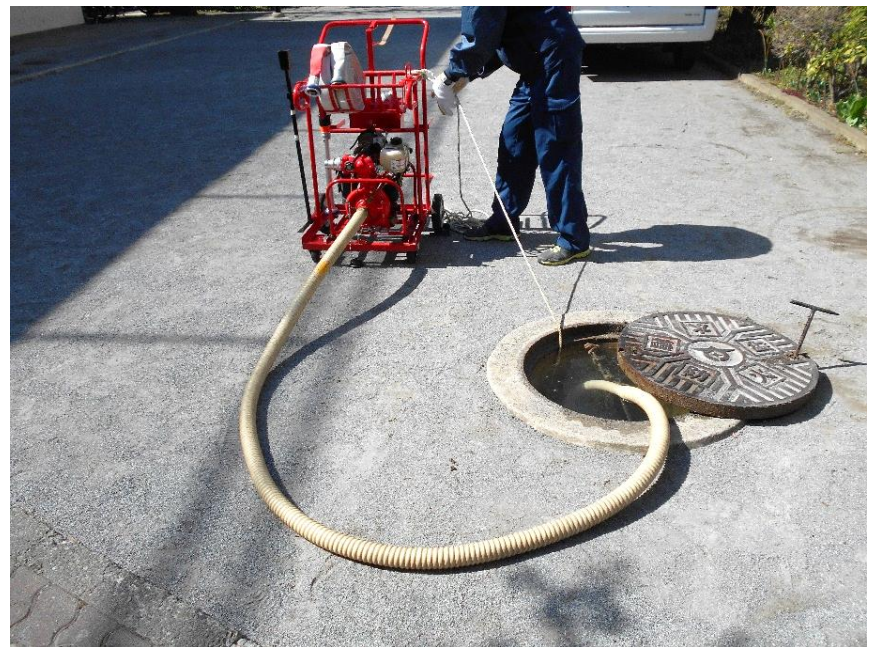
防火水槽に吸管を挿入した吸水完了状態
