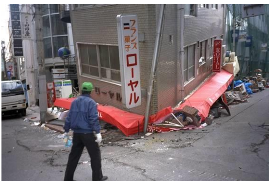
(1階部分がつぶれたが、利用者を近隣住民が救出)
