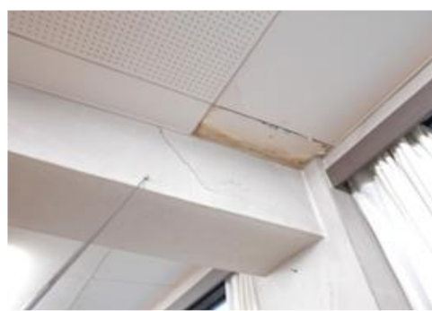
天井の劣化により他部への影響
