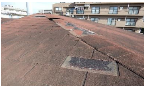
葺き材の広範囲で剥れが発生
