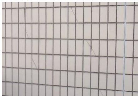
タイル面の部分的なひび割れが発生
