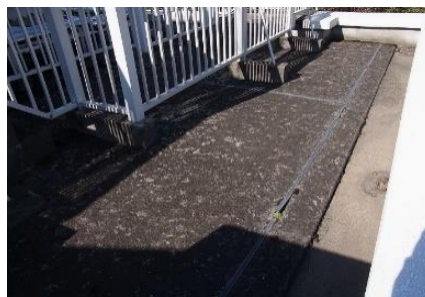
保護防水目地の劣化が進行
