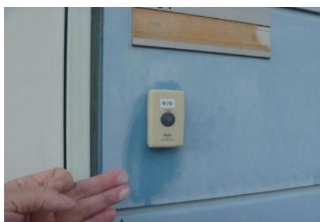
外壁パネルの退色、チョーキング
