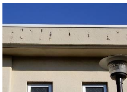
広範囲にひび割れ、爆裂が発生
