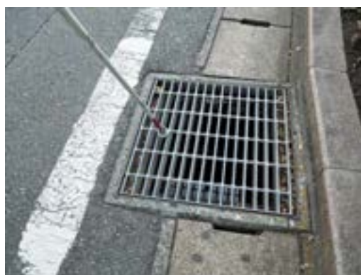
白杖が挟まる隙間の大きいグレーチング
