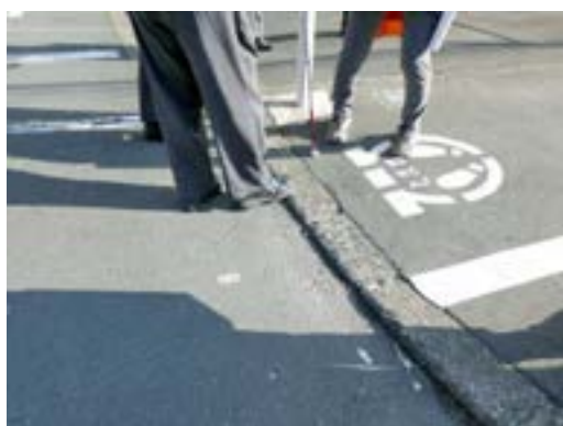
歩道と車道の境にある段差
