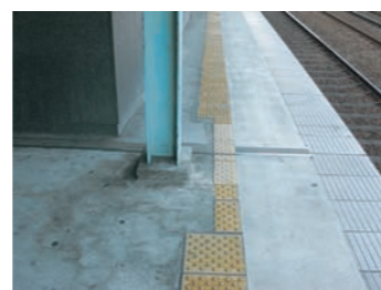
利用者に配慮されていない点字ブロックの配置
