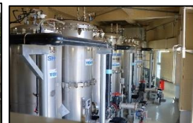
浄化施設建屋内
