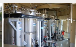
浄化施設建屋内
