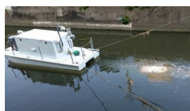
スカム発生抑制装置全景
