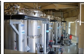
浄化施設建屋内
