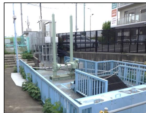
ポンプゲート設備
