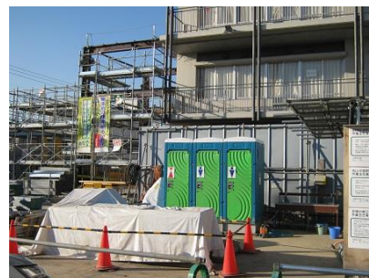
▲作業員用トイレ
