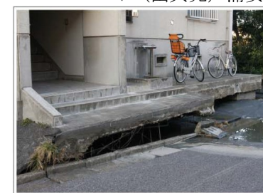
地盤沈下でできた段差
