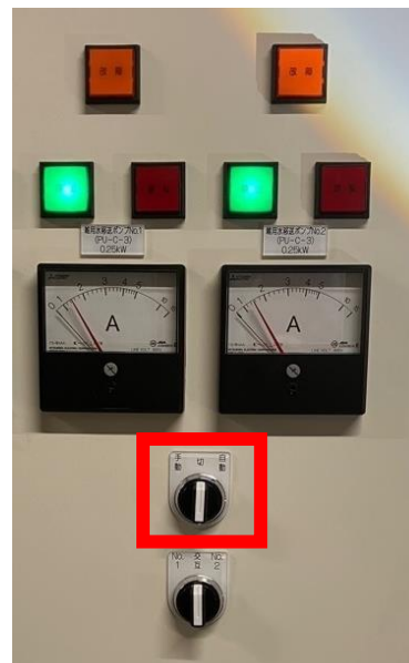
(写真 2.4) 動力盤の起動スイッチ
