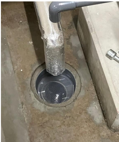
(写真 2.3) 漏水した給水口
