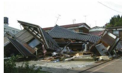
倒壊家屋の現場写真
