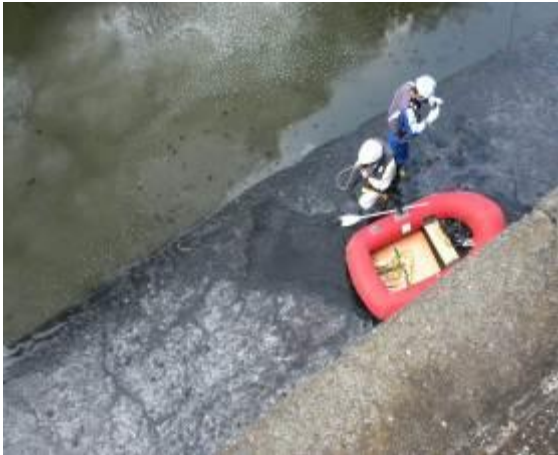
写真 2. 7 汚泥堆積状況（遠景）
