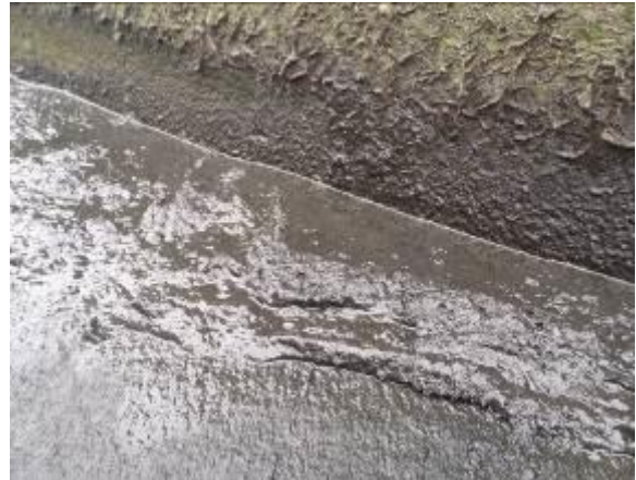
写真 2. 8 汚泥堆積状況（近景）
