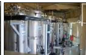
浄化施設建屋内
