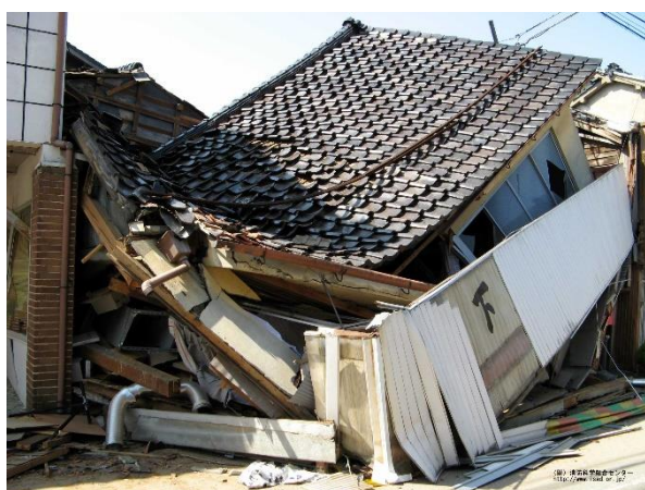
[木造住宅の倒壊]
