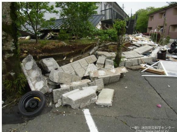
[ブロック塀の倒壊]
