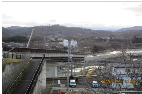
崩落した海野宿橋
