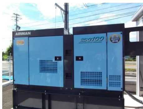
非常用発電機
