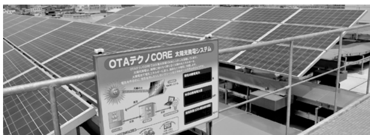
写真は、工場アパートに設置の太陽光発電システム。区では低炭素社会実現に向け、太陽光発電システムの区有施設への導入や、区民への費用助成など、再生可能エネルギーの導入拡大を図っている。
