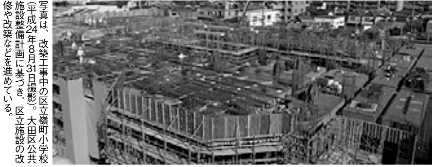
写真は、改築工事中の区立嶺町小学校（平成24年8月31日撮影）。大田区公共施設整備計画に基づき、区立施設の改修や改築を進めている。
