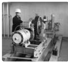
エレベーター機械室
